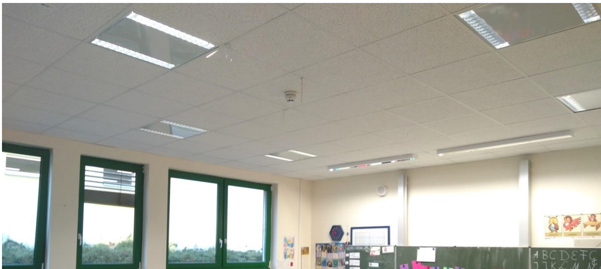
Eingelassene Deckenleuchten in den Zimmern
